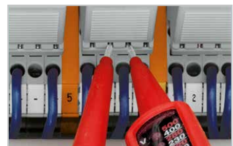
Функциональное испытание при помощи тестовых разъёмов для проверки защиты от касания.
