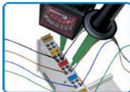
Проверка прохождения сигнала при подсоединенных проводниках
