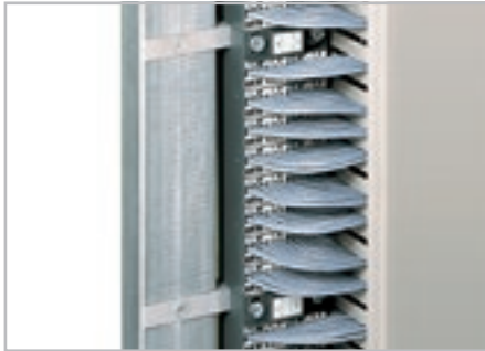
Матричная коммутационная панель на каркасе.
