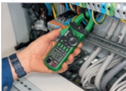
Измерения тока в распределительном шкафу
