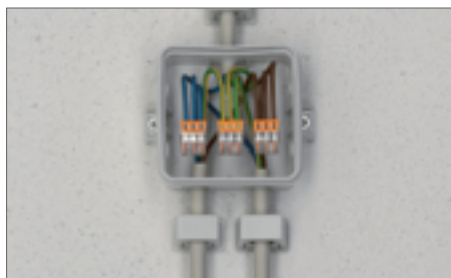
Визуальный контроль проводного монтажа
